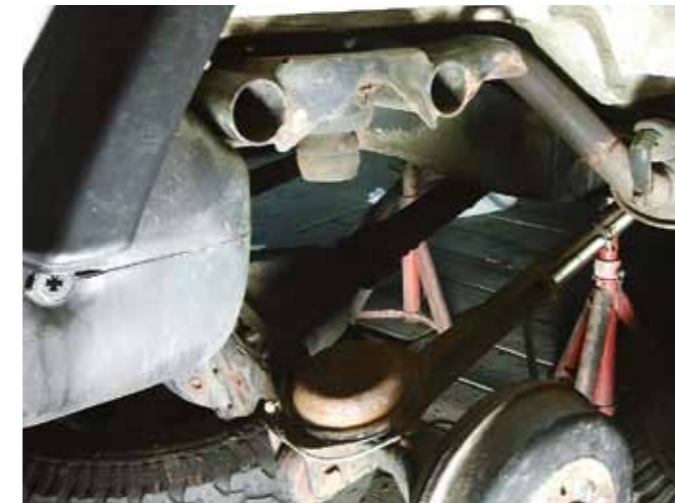
Bild 1 Auf dem ersten Bild sieht das doch gar nicht so schlimm aus. Gefühlt ist es wohl nur etwas stärkerer Flugrost, somit eher was für die Drahtbürste. Geplant war eigentlich, alles gut zu entrostern und mit neuer Farbe zu versehen. Kurze Zeit später kam die erschreckende Ernüchterung: Ist das wirklich durch?
